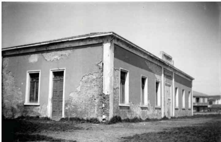
10. Ecco la PALESTRA, "ma che è sempre chiusa". Non è che non serva proprio a niente: è l'indispensabile magazzino comunale delle cose inutili! E' là dentro che avrei voluto andare a scegliere due banchi meno diroccati di quelli assegnati alla nuova scuola media!
